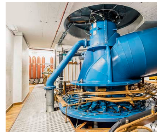
In einem 58 Meter tiefen Schacht sind die maschinellen Anlagen untergebracht.
