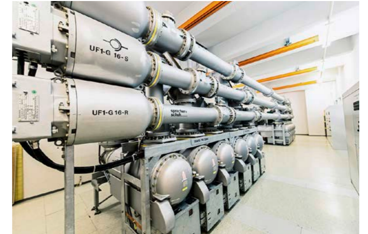
Das Kraftwerk Bockstein war die erste Anlage in Salzburg mit einer „110 kV SF6-Innenraum-Schaltanlage“.
