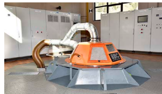
Francis-Turbine und Generator erbringen im Kraftwerk Zederhaus 10 Megawatt Leistung.
